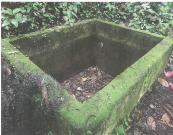
Fotografía 6. Tanque de almacenamiento.
