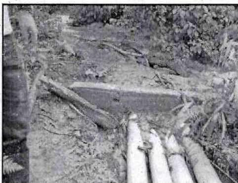
Tubería que conduce el agua captada hacia los estanques.
