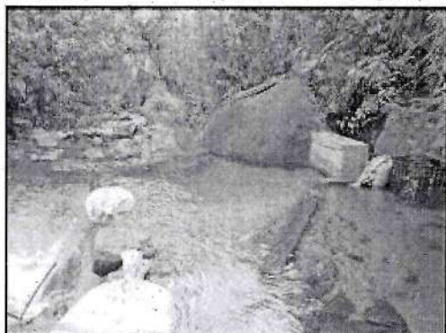
Canal de aducción y captación lateral.
