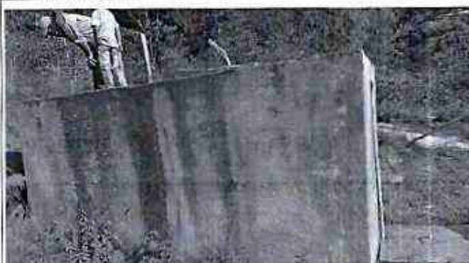
Fotografía 5. Tanque de almacenamiento.
