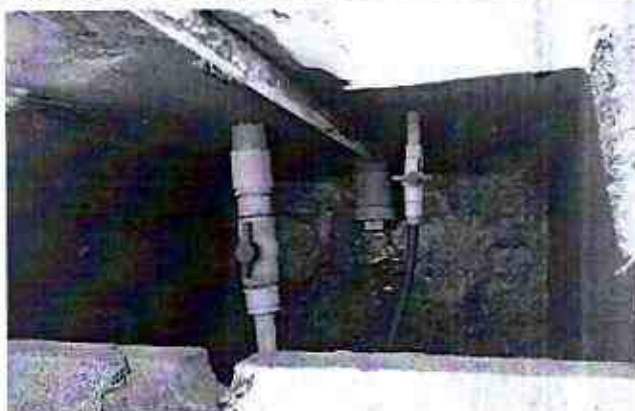
Fotografía 7. Llaves de paso en tanque de almacenamiento.
