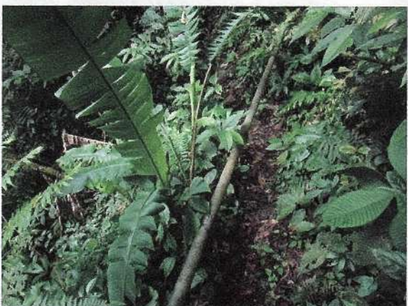
Fotografía 5. Tubería de aducción en hierro galvanizado de 3"
