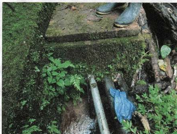
Fotografía 8. Cámara lateral de estabilización de flujo y tuberías de aducción.
