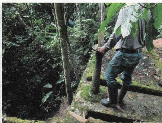
Fotografía 4. Válvula de purga de lodos
