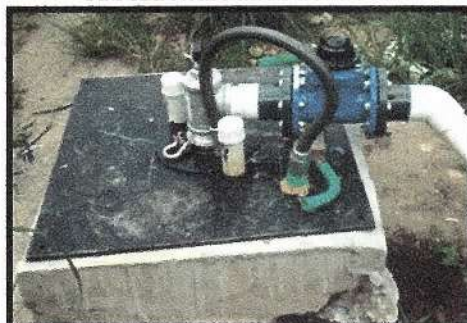
Cabeza Hidráulica del Pozo
