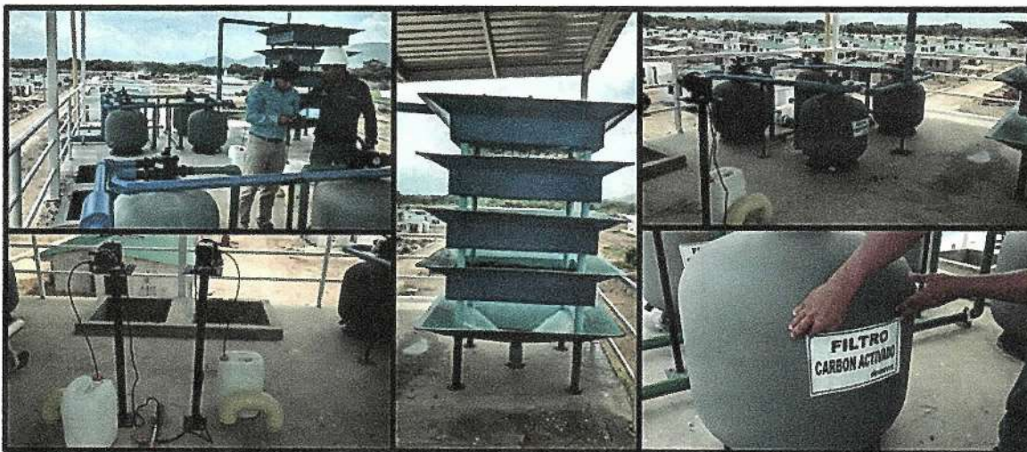
Sistema de tratamiento de agua.
