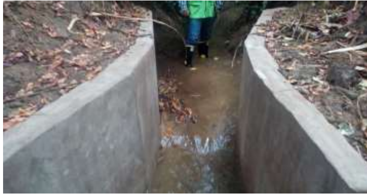
Canaleta Parshall - Predio el Espino Vereda Ceibas Afuera
