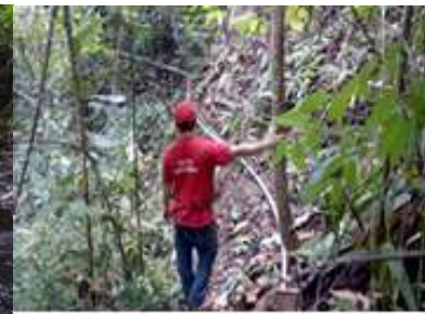
Conducción del agua a través de tubería
