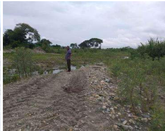
Daños en los Canales o Acequias de captación del recurso del Río Ceibas - Neiva
