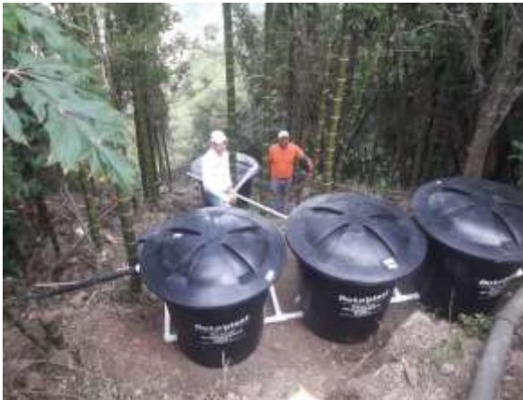
Sistema de tratamiento de aguas mieles de café, Edgar Ángel, vereda Chapuro
