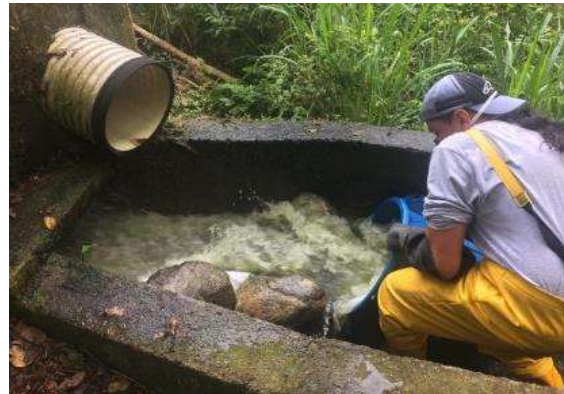
Vertimiento, salida PTAR, municipio de Gigante (efluente)
