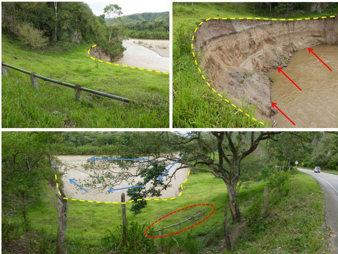
Fotografías que muestran al río Suaza que amenaza con destruir un tramo del acueducto municipal de Altamira y la vía que de ese municipio comunica a Suaza y Florencia.
