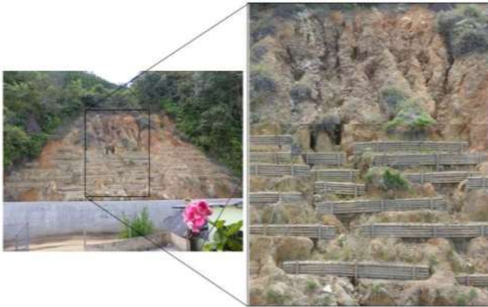
Fotografías tomadas frente a la escuela de Villa María en Iquira, que muestran en detalle la formación de cárcavas en la zona alta, en donde aún no se han construido las obras de control (trinchos). Esto contrasta con la parte inferior en donde ya se han instalado terrazas de estabilización.
