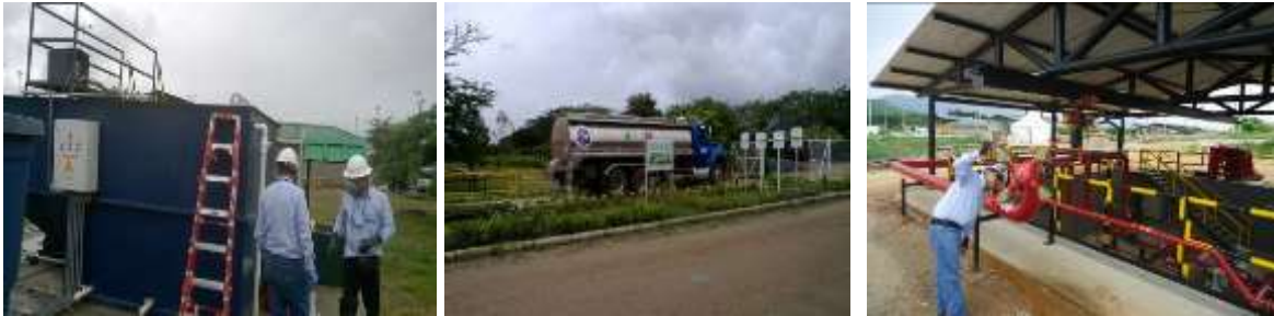
Foto No. 120, 121 y 122 Seguimiento Ambiental a la Planta de mezcla y cargadero de Rioloro-Mun. De Gigante, empresa EMERALD ENERGY S.A, vigencia 2014
