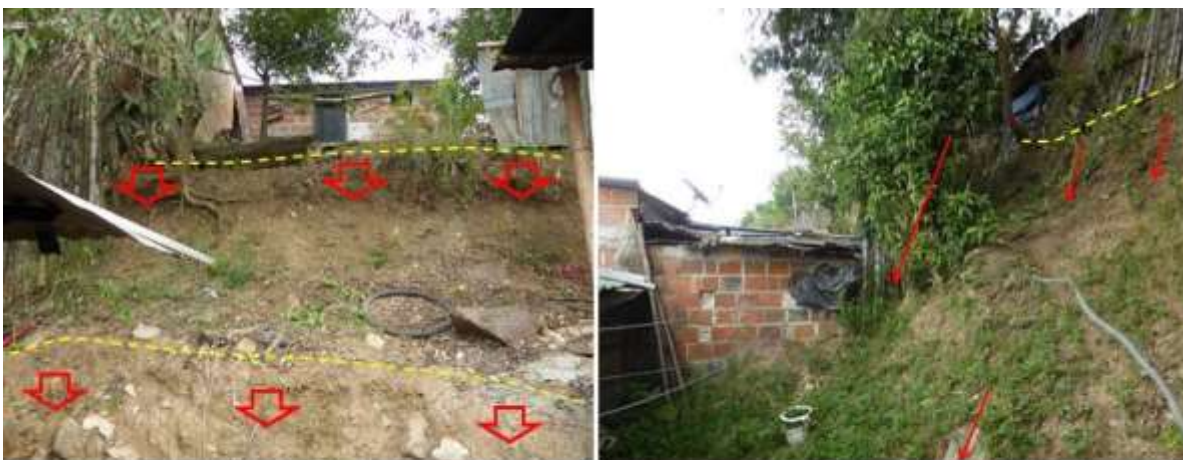
Fotografías que muestran la parte posterior de algunas viviendas del barrio Las Brisas de Gigante. Nótese el riesgo a que están expuestas las viviendas y sus residentes ante fenómenos de remoción en masa.
