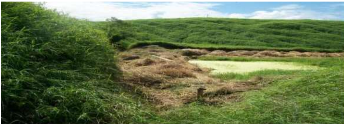
Foto No. 89 Sistema piloto de tratamiento de lixiviados abandonado 2012
