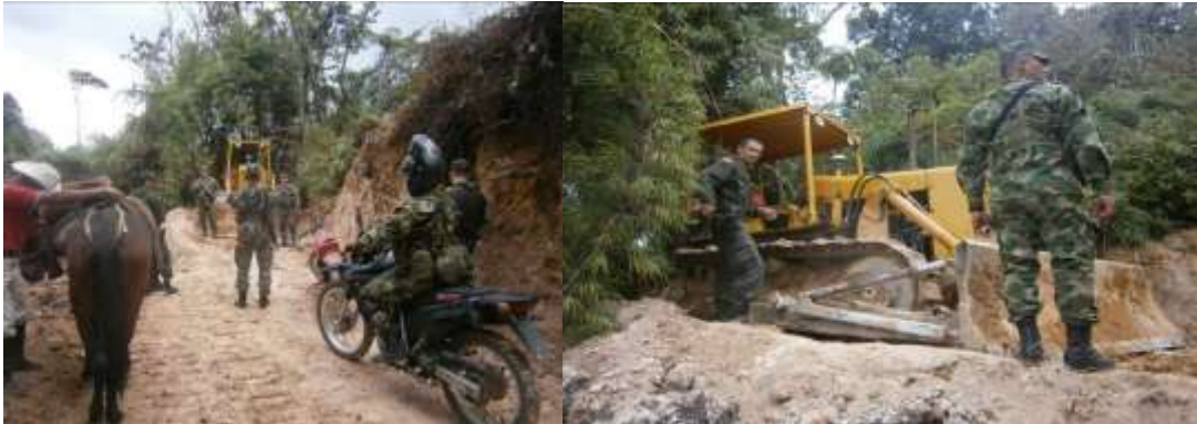
Foto No. 157 y 158 apertura de vía ilegal, vereda La Florida del municipio de Acevedo
