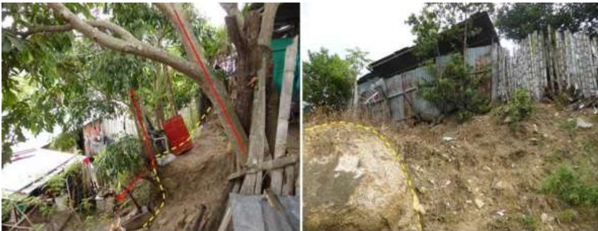
Fotografías que muestran el riesgo en que se encuentran algunas de las viviendas del barrio Las Brisas de Gigante. Nótese la inclinación de los árboles que indican la inestabilidad del sector y los procesos de movimiento que los afectan.
