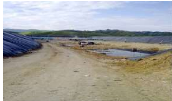
Foto No. 94 Celda en uso 2014
