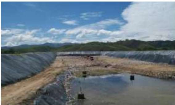
Foto No. 93 Celda en uso 2012
