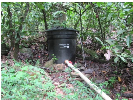
Tanque de distribución de agua para uso doméstico en la vereda Los Cauchos. El sobrante vuelve al drenaje natural.
