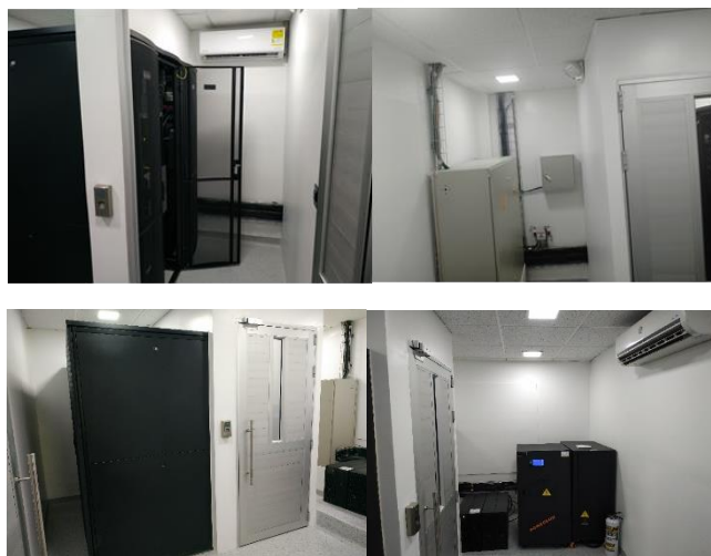
Adecuación de la Subestación Eléctrica Sede Principal CAM
