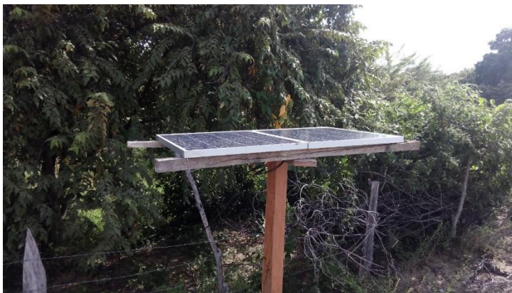
Panel Solar instalado para bomba, beneficiario Jairo Rojas Vereda Libano Municipio de Villavieja
