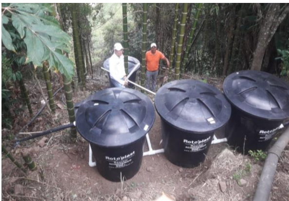
Sistema de tratamiento de aguas mieles de café, Edgar Ángel, vereda Chapuro
