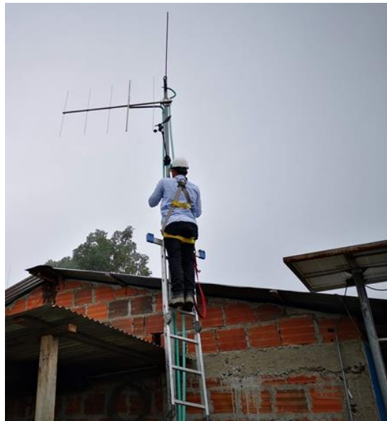
Mantenimiento preventivo en estación de meteorológica El Mesón, Octubre 2019.
