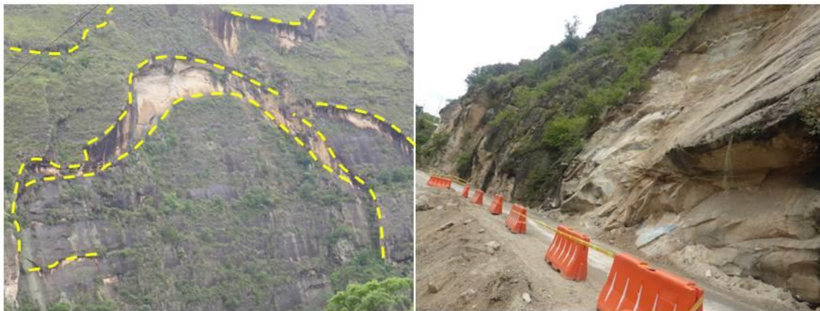
Fotografías en las que se observa el potencial de amenazas por fenómenos de remoción en masa en el sector de Pericongo (vía Altamira-Timaná)
