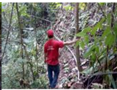
Conducción del agua a través de tubería
