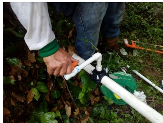
Acometida individual en conducción comunitaria vereda Los Cauchos.
