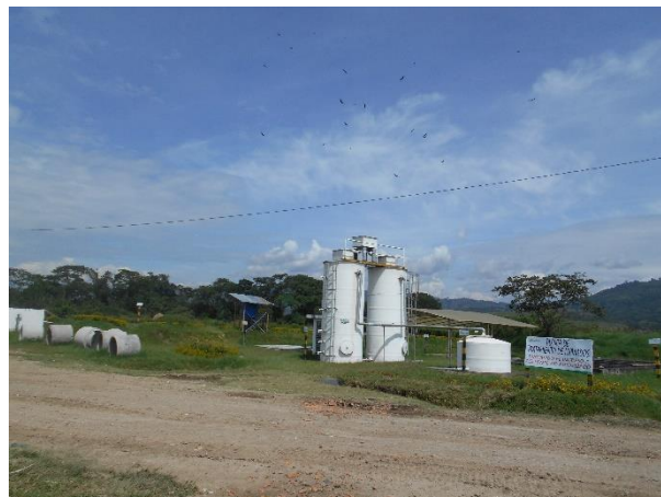
Sistema de tratamiento de lixiviados
