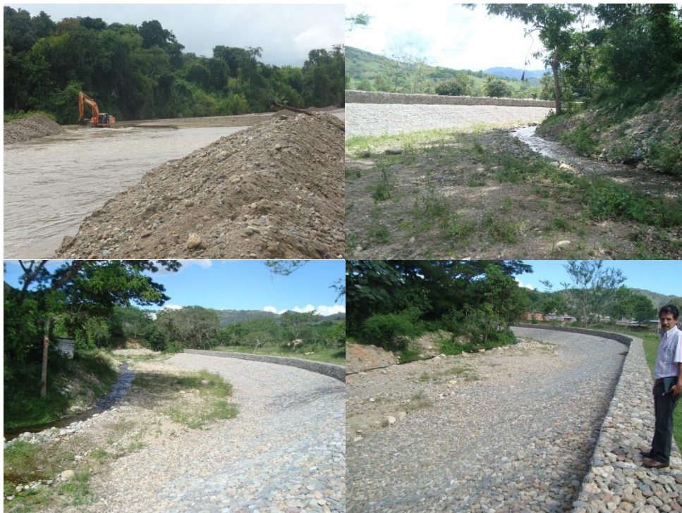
Estado de la Quebrada Emayá después del dragado y descalce
