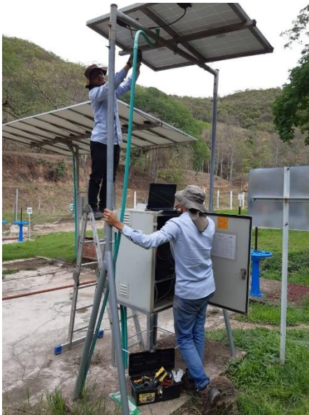
Mantenimiento preventivo en estación de alarma Guayabo, Octubre 2019.
