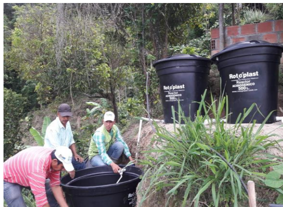
Instalación del Sistema de tratamiento de aguas mieles de café, Jaime Ricaurte, vereda Chapuro.
