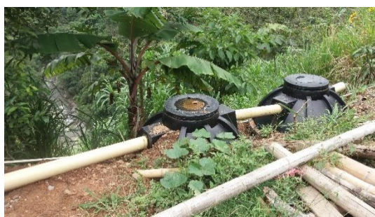
Sistema séptico IMHOFF instalado, vereda Santa Helena.
