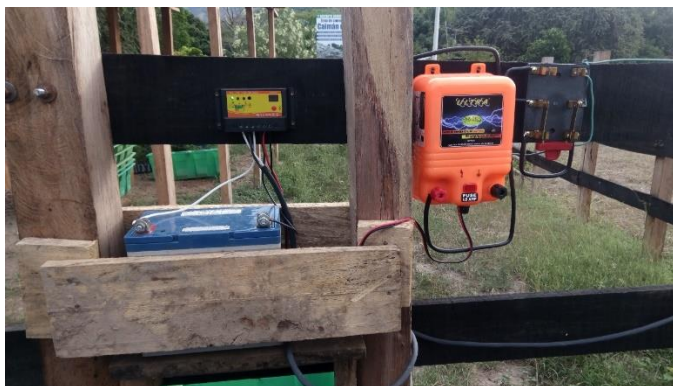
Sistema Eléctrico Instalado beneficiario Ferney Soto, Vereda Líbano Municipio de Villavieja
