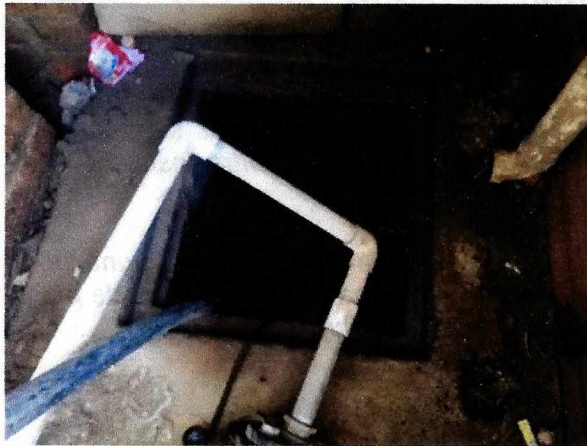
Fotografía 7. Tanque de almacenamiento subterráneo con capacidad de 10.000 litros aproximadamente.
