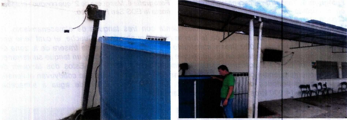
Fotografía 9 y 10. Tuberías que conforman el sistema de recolección de aguas lluvias.
