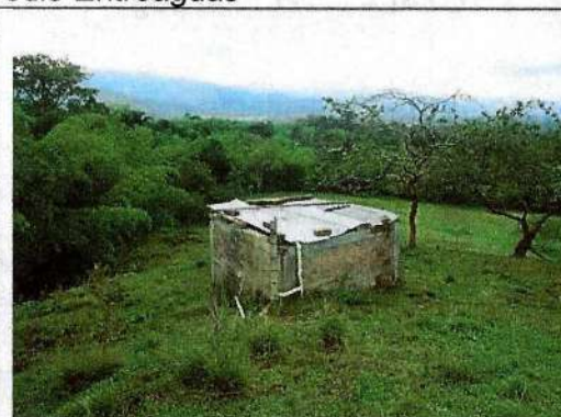
Fotografía 5. Tanque de almacenamiento y distribución
