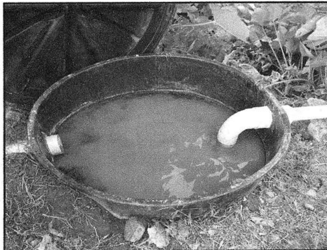
Filtro de flujo ascendente que trata aguas residuales provenientes de la trampa de grasas que recepciona los vertimientos del área de lavado
